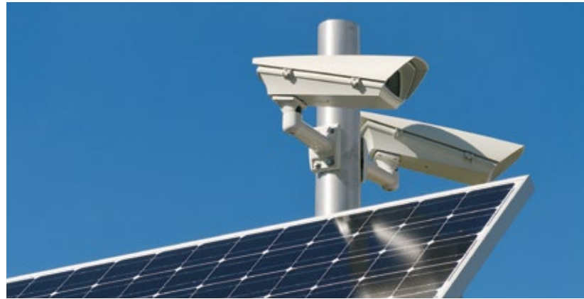
Abb.: Mit installierter Überwachungstechnik lassen sich Fotovoltaik-Diebe abschrecken.
