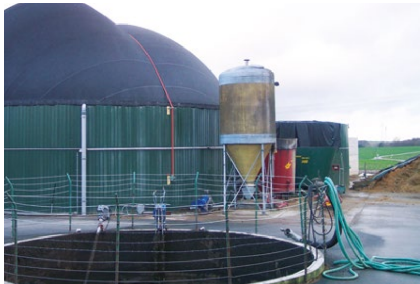
Abb.: Sturmschaden an einer Biogasanlage nach Orkan Kyrill: Die Folienhaube des rechten Fermenters wurde zerstört. Beim vorderen Fermenter konnte die Folienhaube erfolgreich mit einem Spanngurt gesichert werden.
