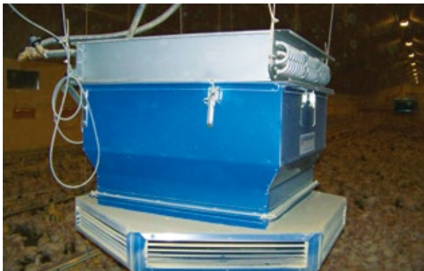
Abb.: Heizung mit Warmwasserkonvektor in einem Geflügelstall
