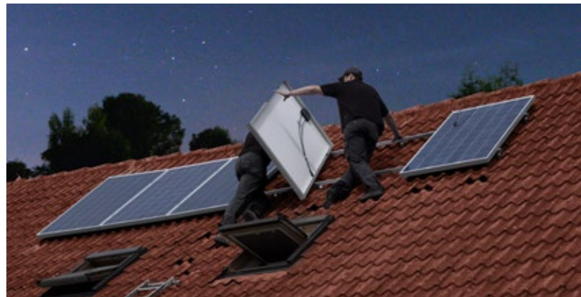
Abb.: Bei Fotovoltaikanlagen an schlecht von außen einsehbaren Orten, kann es leicht passieren, dass Diebe die Module reihenweise abbauen.
